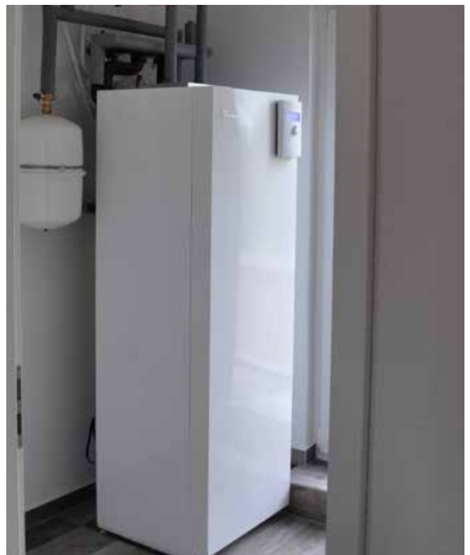
Beispiel WSV im Abstellraum
