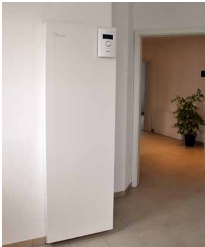
Beispiel WSV im Flur integriert
