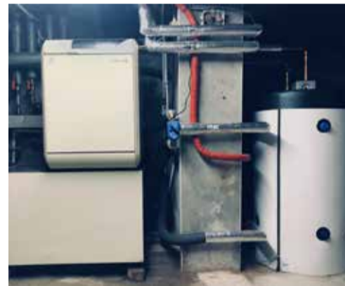
Das alte Heizsystem mit 18kW-Gasheizwertkessel
