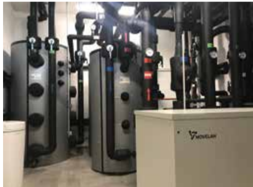
Die Zentrale der Heizungsanlage
